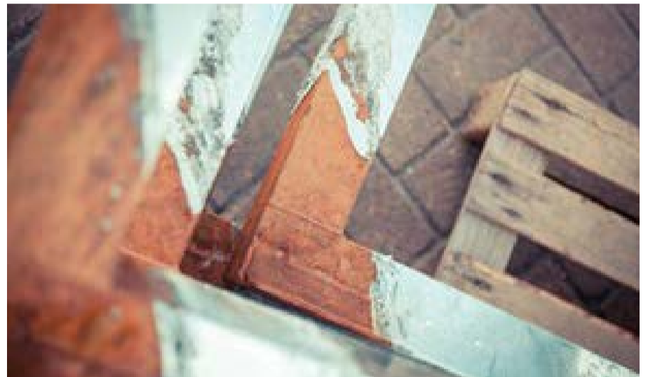
Foto 7 - wegens het niet aanbrengen van voldoende ontluuchtingsgaten, is het object blijven drijven
