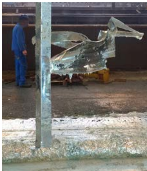
Foto. 8 - geëxplodeerde tussenkoker in een frame door het ontbreken van verzinkgaten
