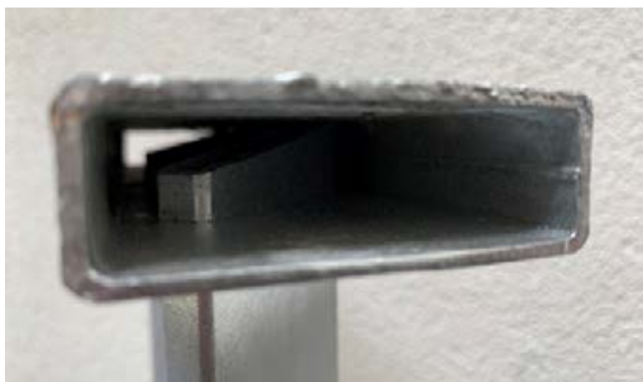
Foto 3 - detail niet zichtbare verzinkgaten in geval van een lamellenhekwerk
