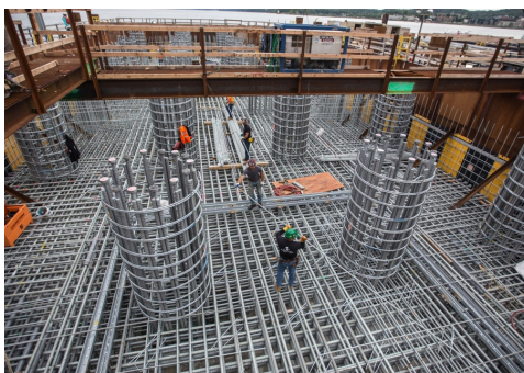
Voorafgaand aan de keuze voor verzinkt betonstaal voor de Mario M. Cuomobrug ontwikkelde de New York Thruway Authority een corrosiebeschermingsplan om de blootstelling, degradatiemechanismen, ontwerp- en constructiedetails en levenscycluskosten vast te stellen.
