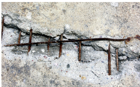
Scheuren en afbrokkelen van beton door corrosie van het betonstaal
