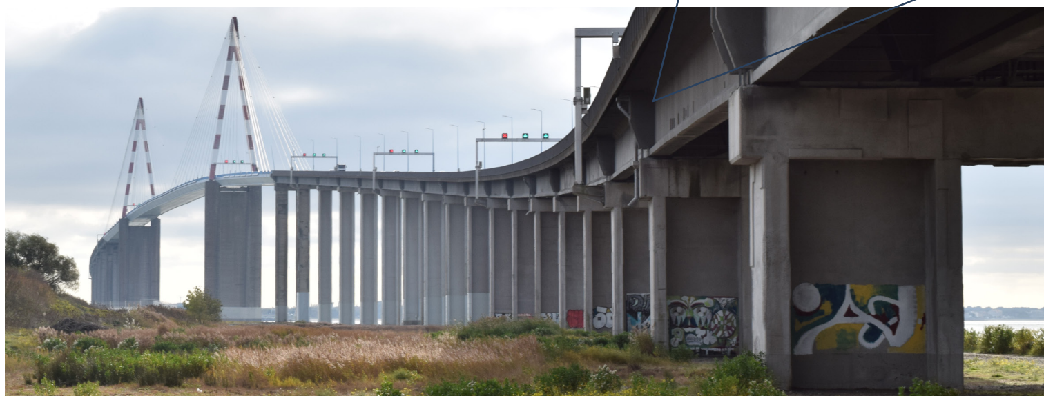
De Saint-Nazaire brug werd gebouwd in de jaren 1970 en is nog steeds de langste brug in Frankrijk. Het grootste deel van de betonwapening was niet beschermd tegen corrosie en dit heeft geleid tot een uitgebreid programma van onderhoud en reparaties. Ongeveer 63 ton verzinkte stalen wapening werd gebruikt op zeer specifieke locaties - de flenzen van de T-balkuiteinden en de ter plaatse gegoten verbindingen ter hoogte van de flenzen (zie foto hierboven). Reparaties waren niet nodig op die specifieke locaties waar de thermisch verzinkte wapening werd gebruikt.
