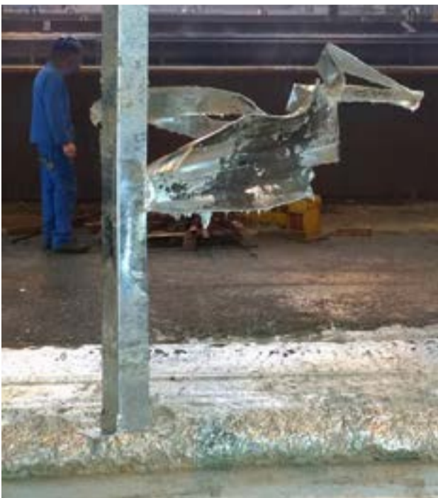
Photo. 8 - explosion d'un manchon intermédiaire dans un cadre en raison de l'absence de trous de fraisage
